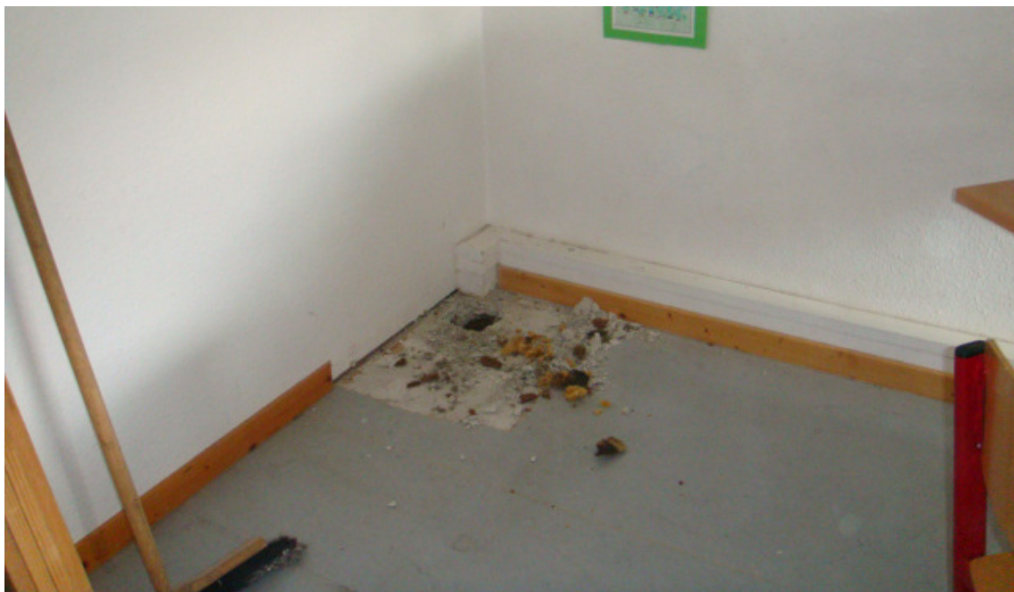
Abb. 5: Öffnung des Fußbodens mit Auffälligkeiten des Dämmmaterials
