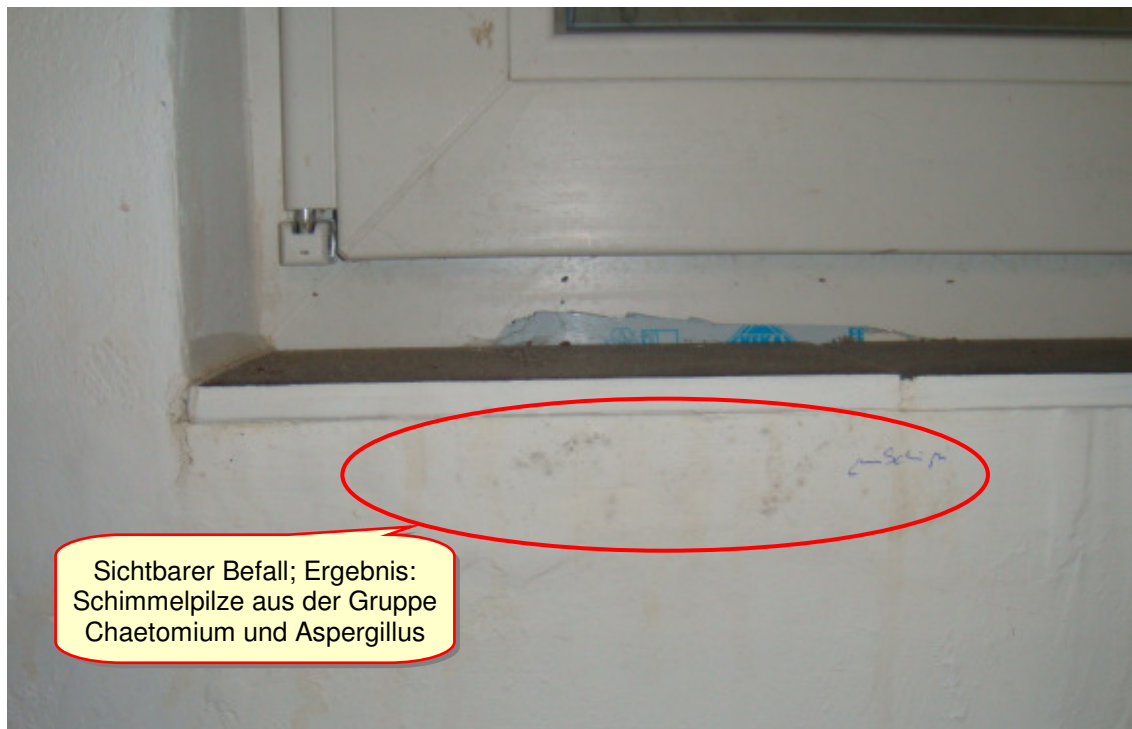
Abb. 3: Schimmelpilzbefall an Kellerwand unterhalb Fenster
