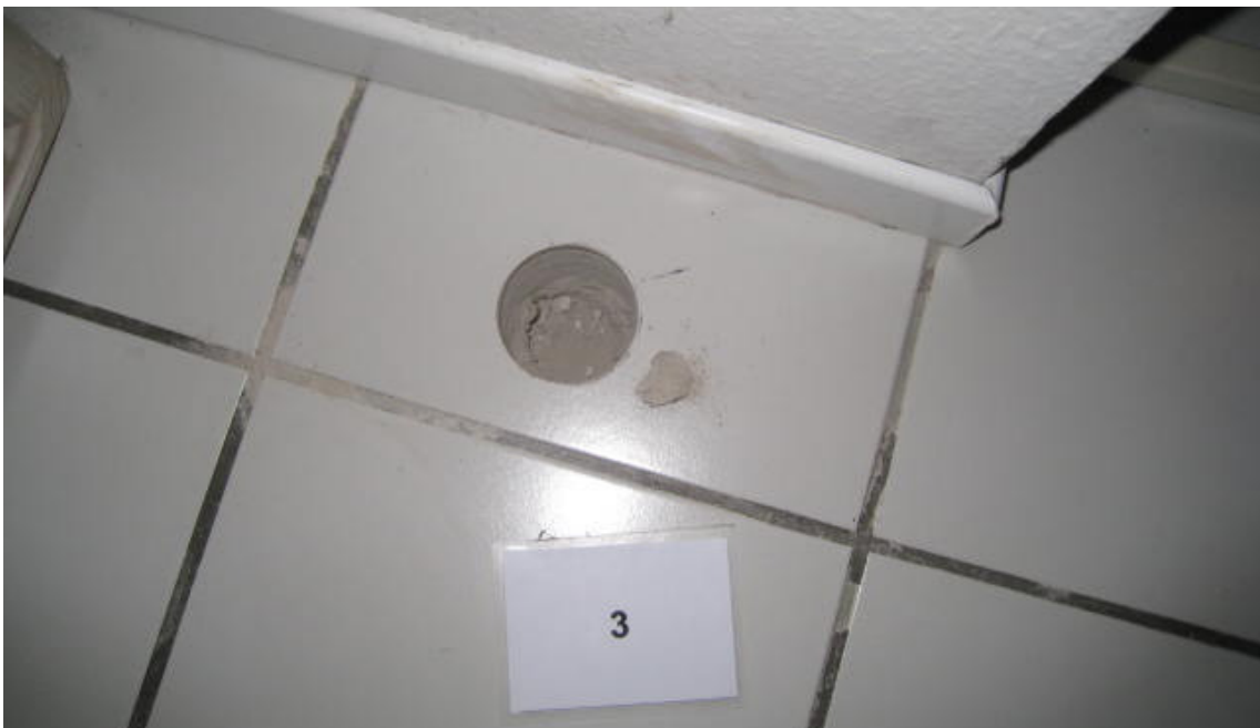
Abb. 8: Probe außerhalb Schadensbereich, Referenz
