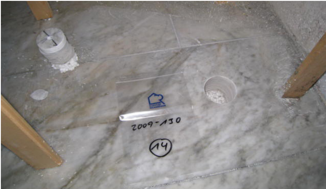
Abb. 7: Probe in mutmaßlichem Schadensbereich
