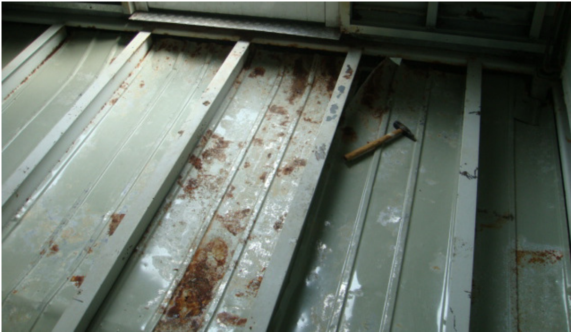
Abb. 6: Stahlblech-Unterboden mit Korrosion
